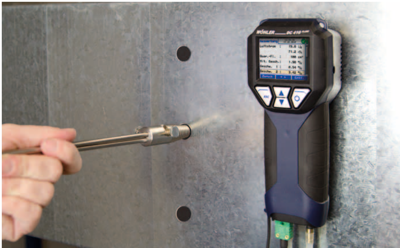
Trivialmessung am rechteckigen Luftkanal mit dem Wöhler DC 410 FLOW und dem Staurohr Typ S
